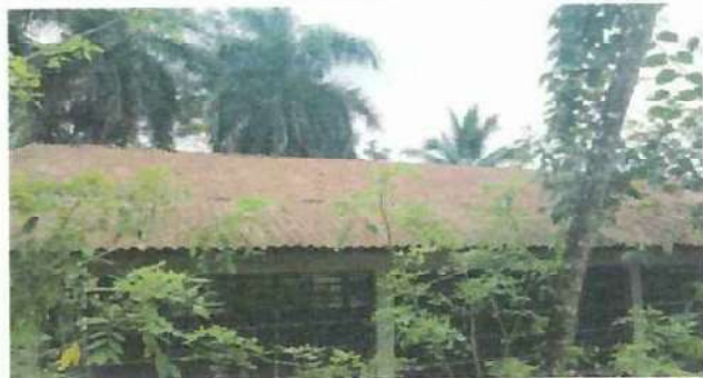
Foto1: CUBIERTO DE LAMINA POR DETERIORO
